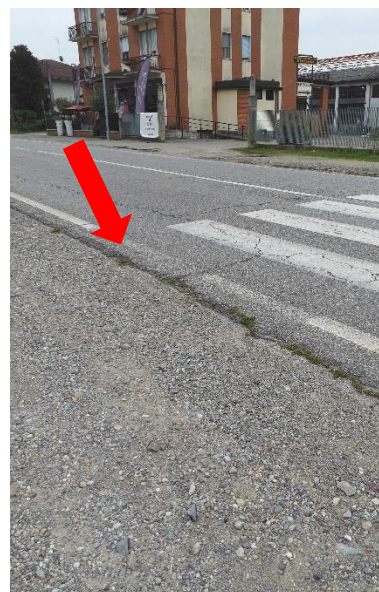
Foto 4 – Viale Europa – sbarco con pavimentazione sconnessa
