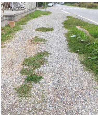
Foto 5 – Viale Europa – pavimentazione sconnessa
