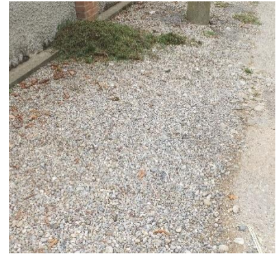
Foto 2 - Via Maggiore - banchina con pavimentazione non compatta
