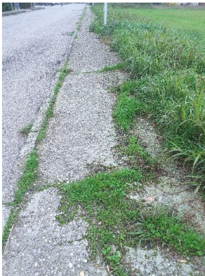
Foto 7 – Via Vignola – marciapiede con pavimentazione sconnessa
