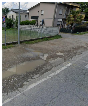
Foto 6 – Viale Europa – pavimentazione sconnessa
