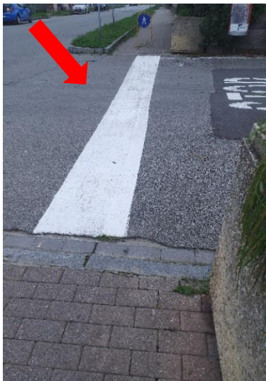
Foto 3 – Via Milano – attraversamento pedonale non segnalato
