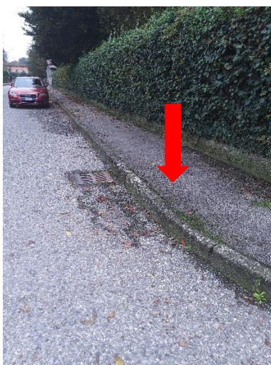
Foto 1 – Via Torchiera – sbarco mancante
