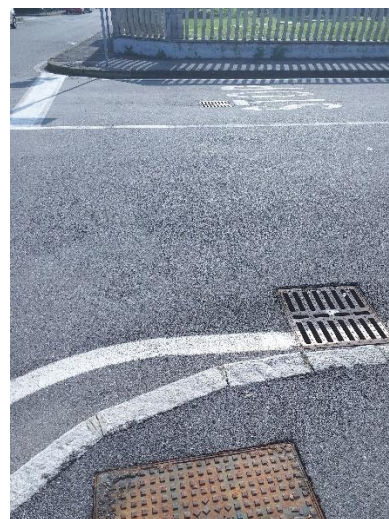
Foto 4 – Via F.Ili Cervi – attraversamento pedonale mancante
