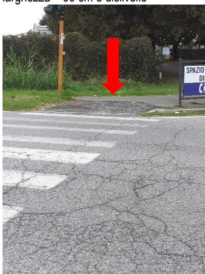
Foto 3 – Via dei Caduti – sbarco con pavimentazione dissestata
