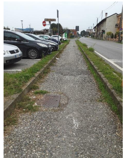
Foto 2 – Via Indipendenza – pavimentazione sconnessa
