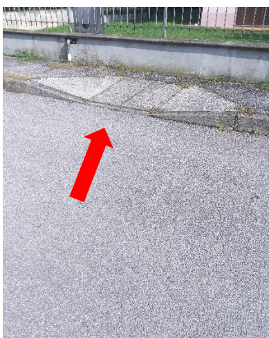
Foto 5 – Via F.Ili Cervi – ostruzione nella sezione di passaggio
