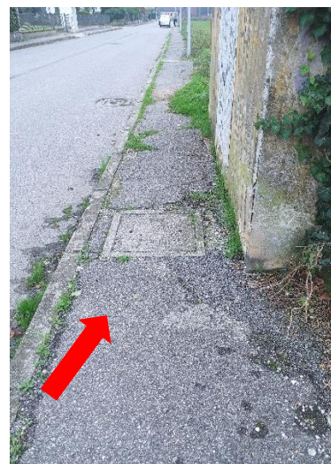
Foto 10 – Via Vignola – marciapiede con larghezza < 90 cm
