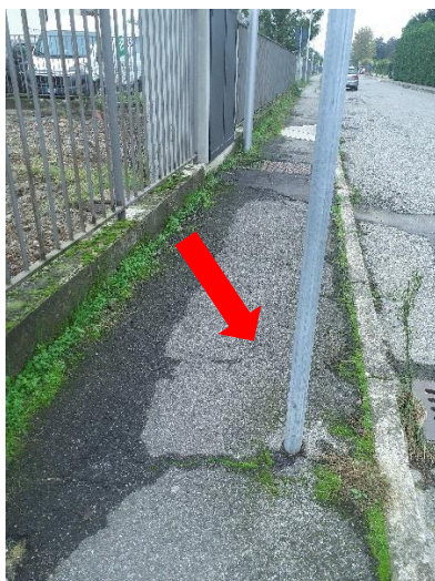
Foto 9 – Via Vignola – ostruzione nella sezione di passaggio
