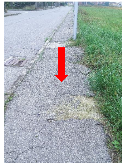
Foto 6 – Via Vignola – marciapiede con pavimentazione sconnessa
