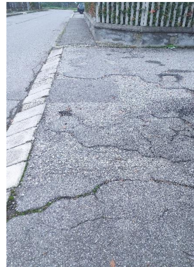
Foto 8 – Via Vignola – marciapiede con pavimentazione sconnessa
