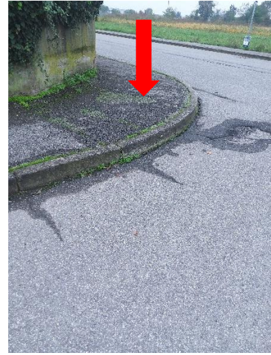
Foto 4 – Via Vignola – sbarco mancante
