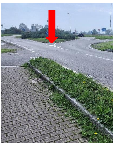
Foto 1 – Via Garibaldi – attraversamento pedonale mancante
