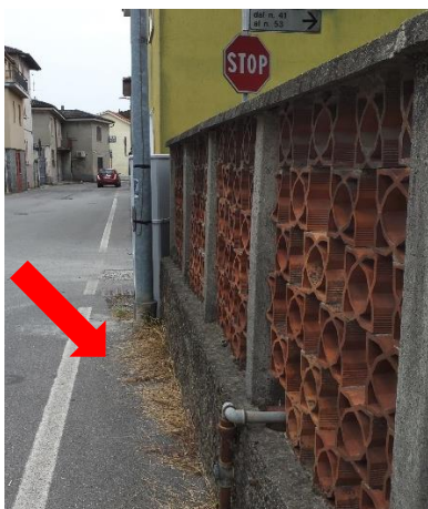
Foto 5 – Via Gradella – Ostruzione nella sezione di passaggio
