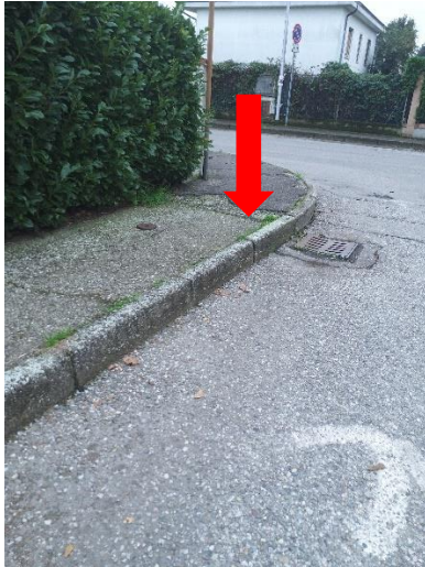
Foto 3 – Via Vignola – sbarco mancante
