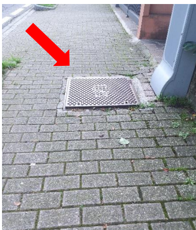
Foto 3 – Via Garibaldi – ostruzione nella sezione di percorso
