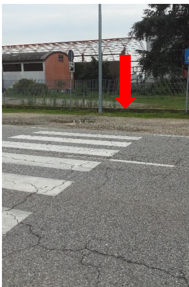
Foto 3 – Viale Europa – sbarco con pavimentazione sconnessa
