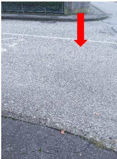
Foto 5 – Via Vignola – attraversamento pedonale mancante
