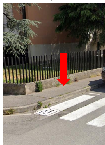
Foto 4 – Circonvallazione B – sbarco mancante
