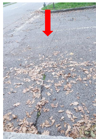
Foto 2 – Via dei Caduti – attraversamento pedonale mancante
