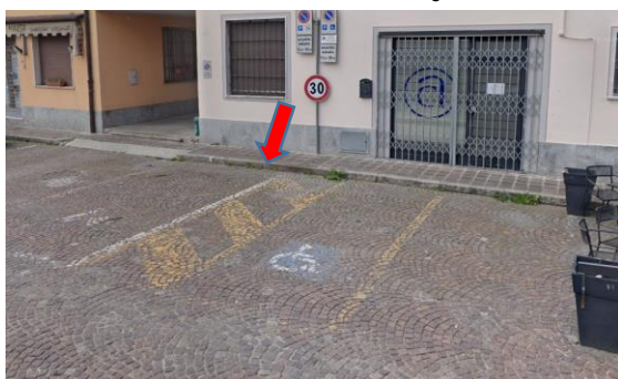
Foto 1 – Vista dalla Piazza – stallo riservato – accesso a marciapiede con dislivello > 2 cm – BA
