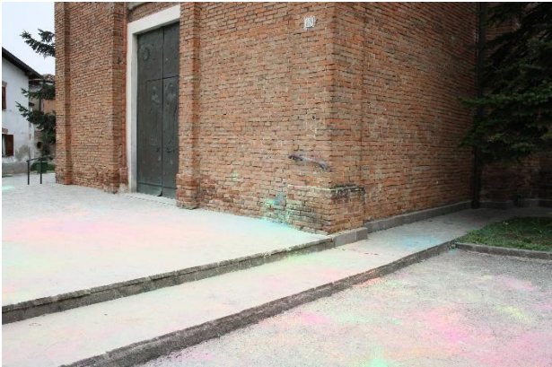
Foto 3 – Accesso da via Gradella – corrimano non a norma – BA
