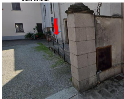
Foto 4 – Rampa di accesso alla porta lato nord da spazio privato - non segnalata
