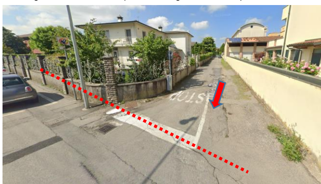
Foto 1 – Pavimentazione ammalorata; attraversamento pedonale non segnalato; Larghezza banchina < 90 cm. - BA
