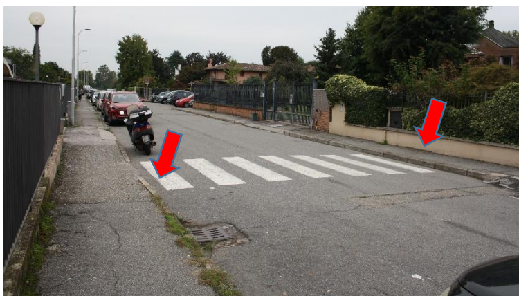
Foto 1 – Attraversamento pedonale via della Vignola: dislivello < 2 cm e tracciamento fuori asse - BA
