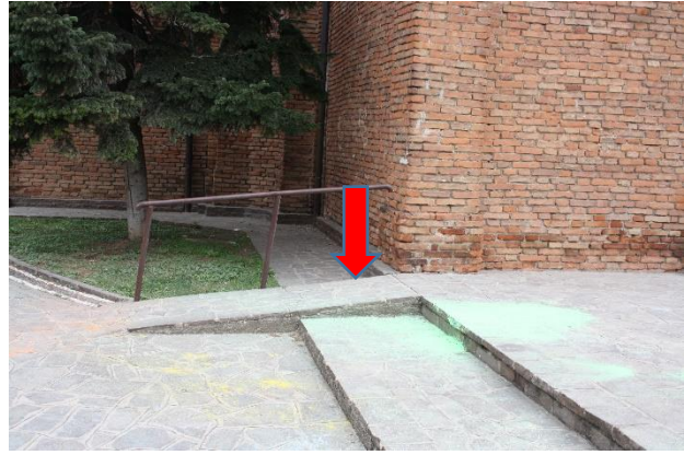
Foto 2 – Rampa di accesso al sagrato non a norma – BA.
