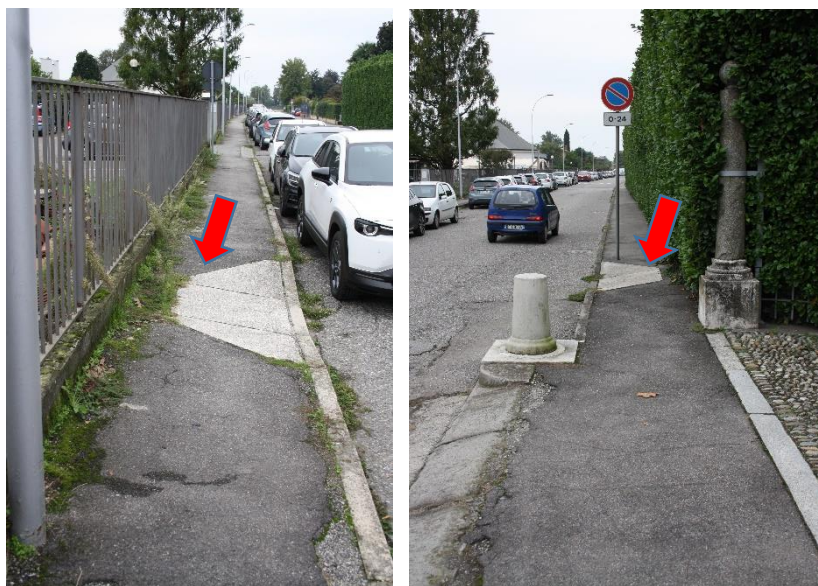
Foto 2, 3 – Marciapiede via Vignola: Scivoli non a norma – ostacolo nella sezione di passaggio - BA
