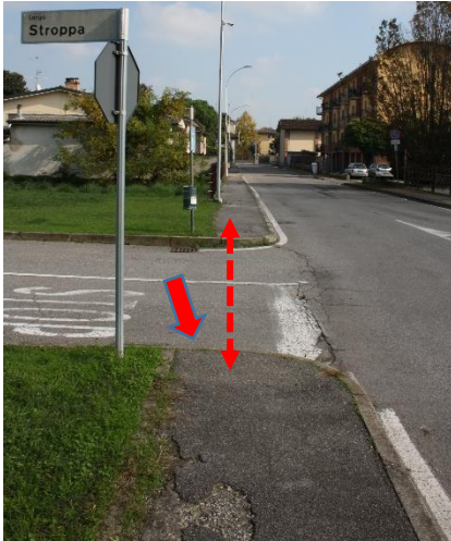
Foto 2 – Attraversamento pedonale non segnalato, dislivello non raccordato - BA
