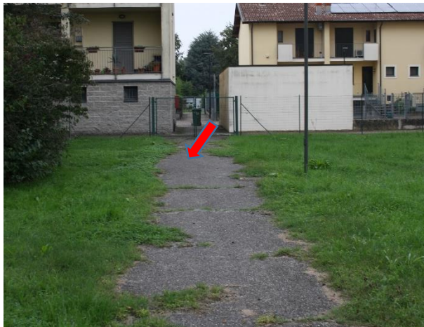
Foto 7 – Ingresso pedonale – pavimentazione ammalorata
