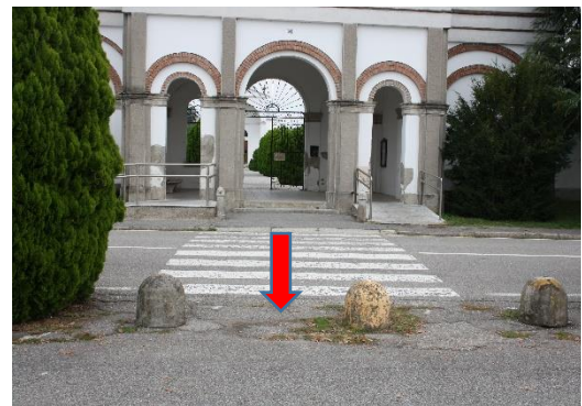
Foto 2 – Attraversamento pedonale: ostacoli allo sbarco; pavimentazione sbarco ammalorata – BA
