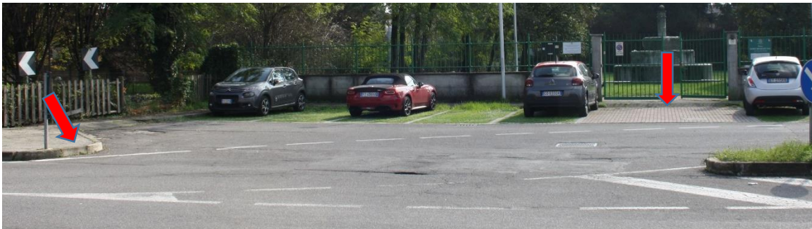
Foto 4 - Dislivelli tra marciapiede e parcheggio non raccordati o pendenza > 9% - BA
