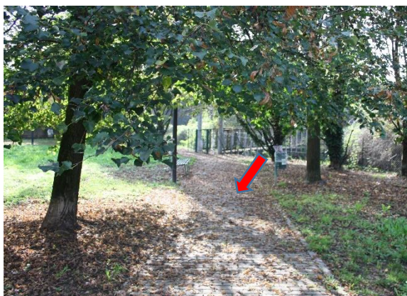
Foto 2 - Percorso interno: pavimentazione puntualmente ammalorata.
