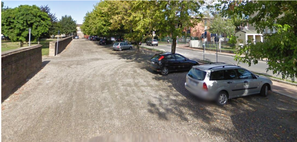
Foto 1 – Parcheggio area rossa: Pavimentazione dissestata e non compatta; stallo disabili non segnalati.
