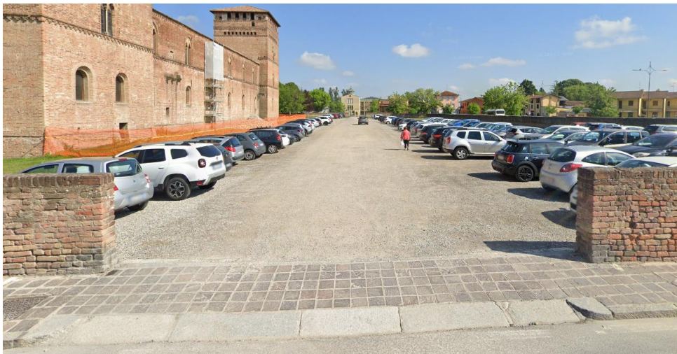
Foto 3 – Parcheggio area verde: Pavimentazione dissestata e non compatta; stalli disabili non segnalati.
