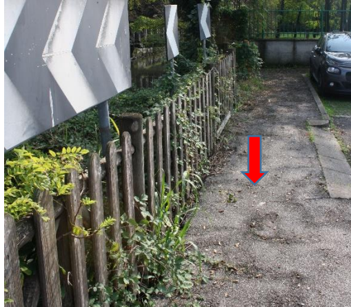
Foto 2 - Marciapiede perimetrale: pavimentazione ammalorata
