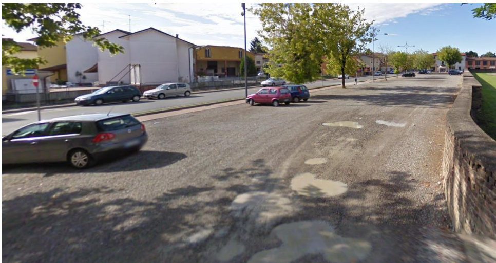
Foto 2 – Parcheggio area viola: Pavimentazione dissestata e non compatta; stalli disabili non segnalati.
