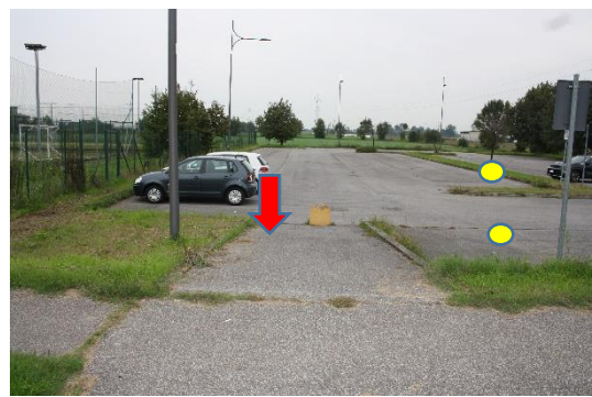
Foto 8 – Accesso pedonale: pendenza > 9% – BA.
