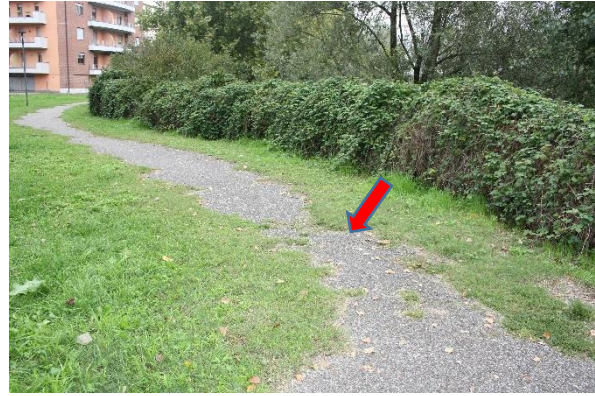
Foto 6 – Percorso pedonale – pavimentazione ammalorata
