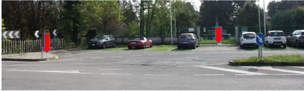
Foto 1 - Vista parcheggio A.: stallo disabili non segnalato; pavimentazione stalli non conforme - BA
