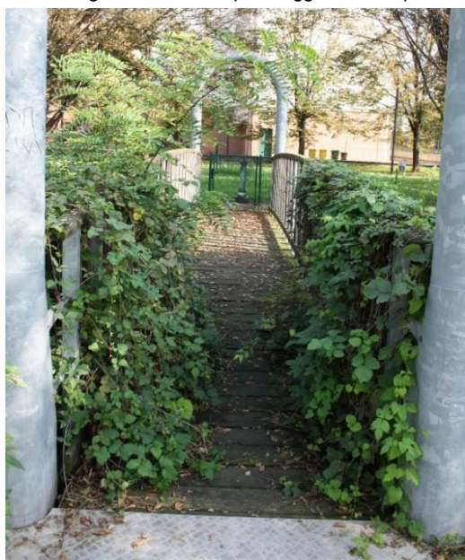
Foto 3 - Pavimentazione ponticello ammalorata
