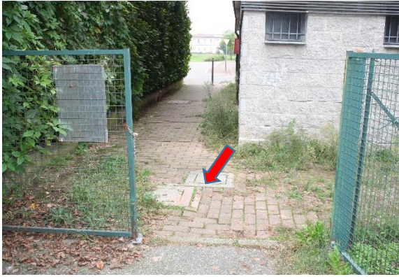
Foto 5 – Ingresso pedonale – pavimentazione disassata
