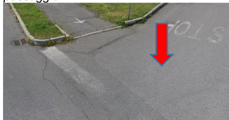
Foto 7: Via Roggetto - attraversamento pedonale mancante
