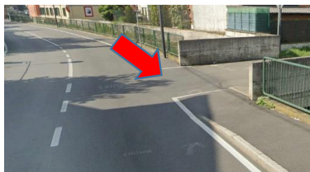
Foto 9: Via Roggetto – attraversamento pedonale mancante
