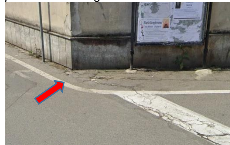
Foto 4: Via Circonvallazione A - pavimentazione dissestata e ostruzione nella sezione di passaggio
