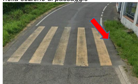
Foto 6: Via Maggiore - Percorso pedonale mancante
