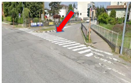
Foto 11: Via Roma - attraversamento pedonale - lunghezza non a norma, manca salvagente.
