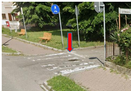
Foto 1: Via Castello - pavimentazione dissestata; segnaletica non leggibile
