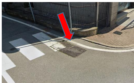
Foto 5: Via Circonvallazione A - sbarco mancante e ostruzione nella sezione di passaggio
