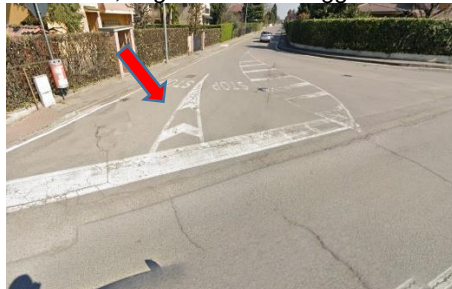
Foto 3: Via Castello - attraversamento pedonale mancante
